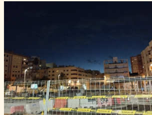
Foto 2. Plaza Trabajadores del Calzado. Aunque la plaza está en obras, destacar la falta de iluminación, las farolas son de poca intensidad.
